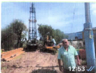
Visitando las obras de perforación de reposición del pozo de agua potable del pueblo
